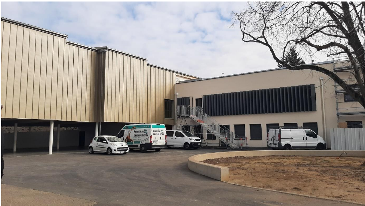
Groupe scolaire Simone Signoret à Saint-Priest (rénovation et extension) Réduction des consommations énergétiques de 30% en ratio surfacique
